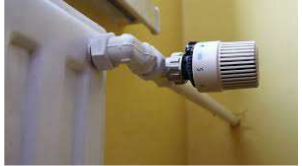
㊵ 판형 방열기 하부 공급관에 설치한 예 (수평 설치)
